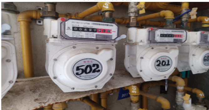
Contador de Gas
