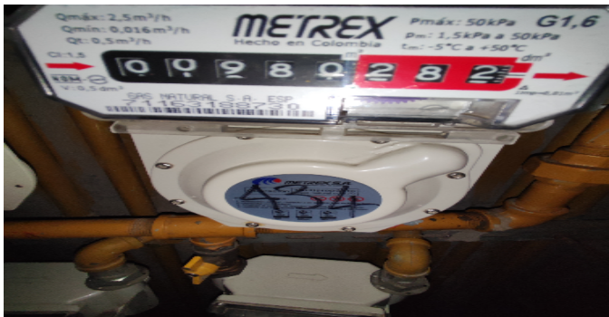
Contador de Gas
