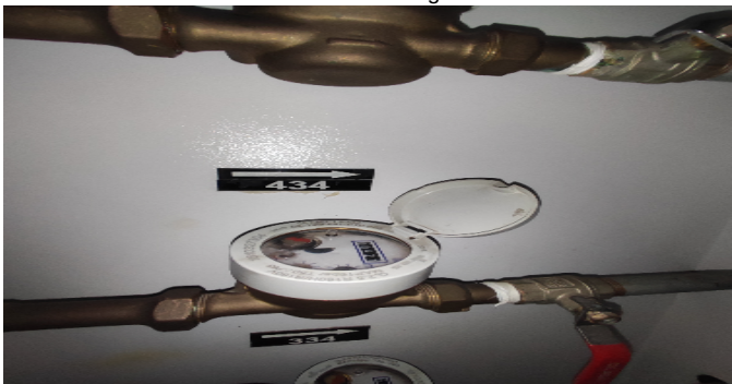
Contador de Agua
