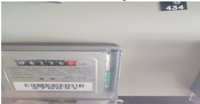
Contador de Energia
