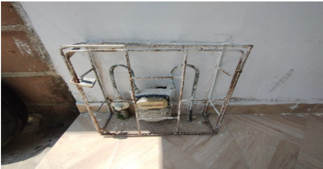
Contador de Gas
