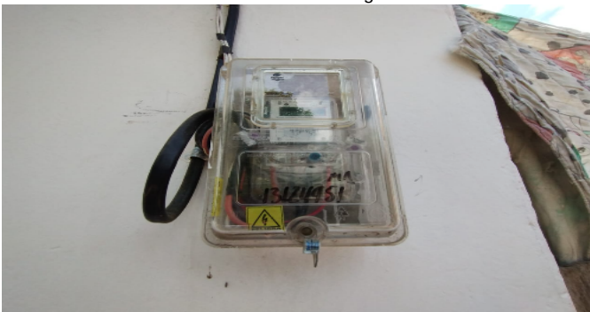
Contador de Energia
