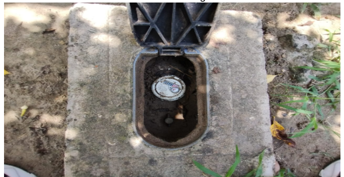
Contador de Agua
