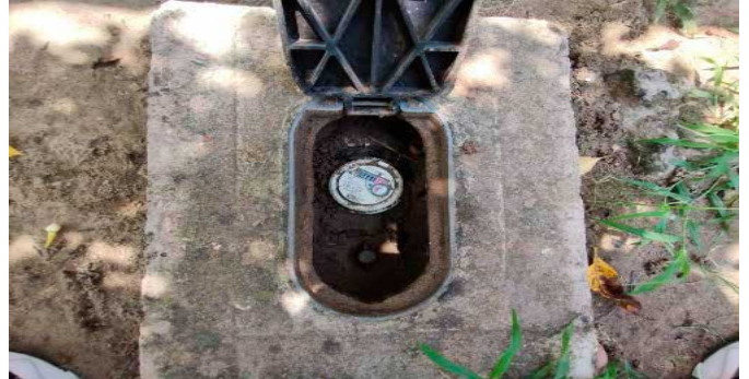
Contador de Agua
