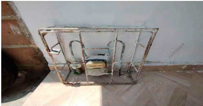
Contador de Gas
