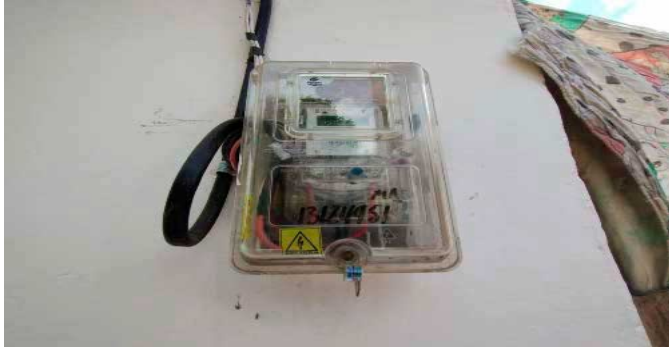
Contador de Energia
