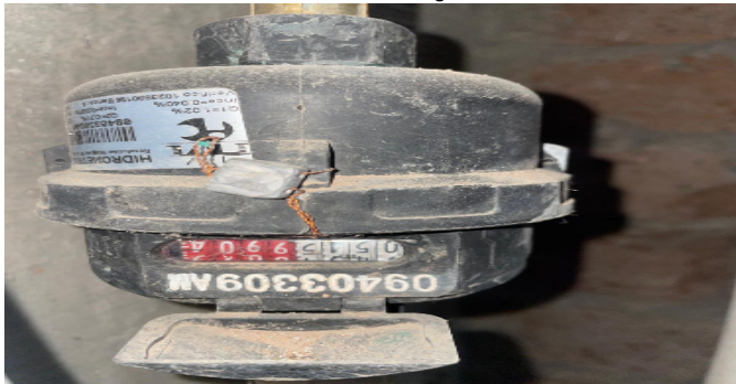
Contador de Agua
