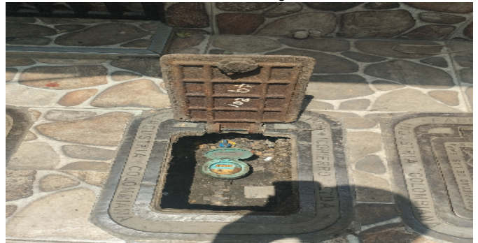
Contador de Agua
