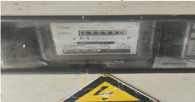
Contador de Energia
