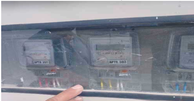
Contador de Energia
