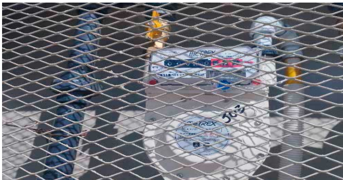
Contador de Gas
