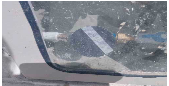
Contador de Agua
