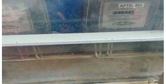
Contador de Energia
