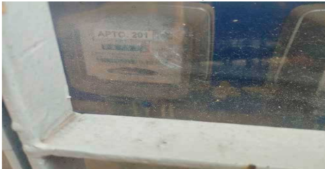
Contador de Energia
