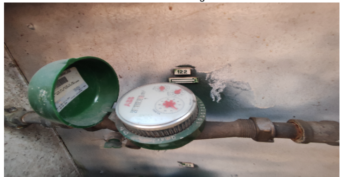
Contador de Agua
