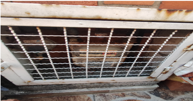
Contador de Gas
