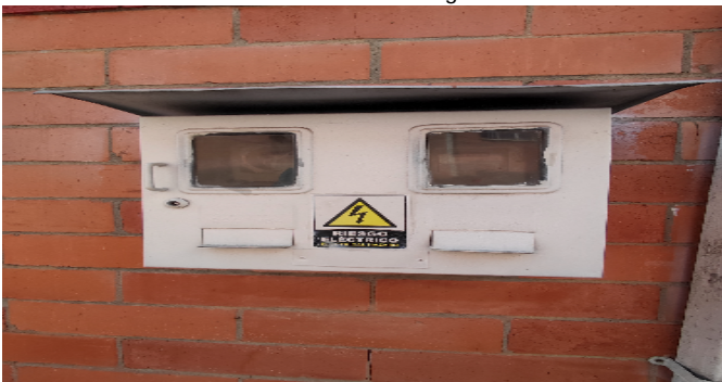
Contador de Energia
