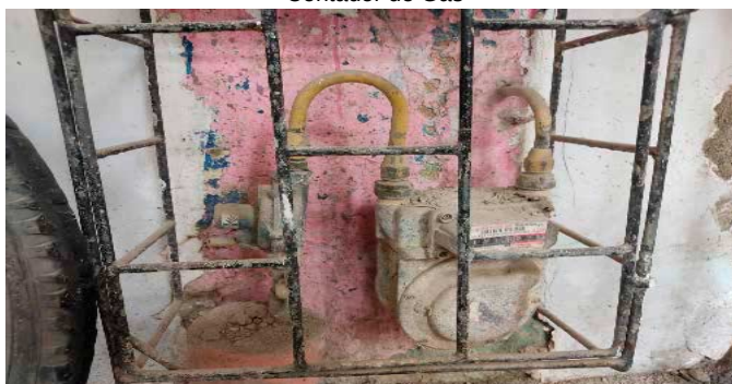
Contador de Gas
