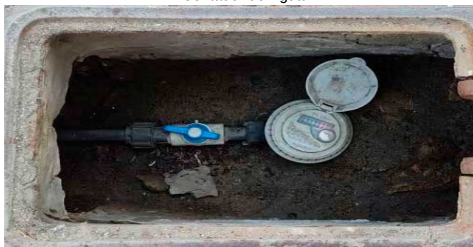
Contador de Agua
