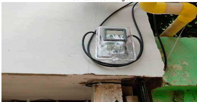
Contador de Energia
