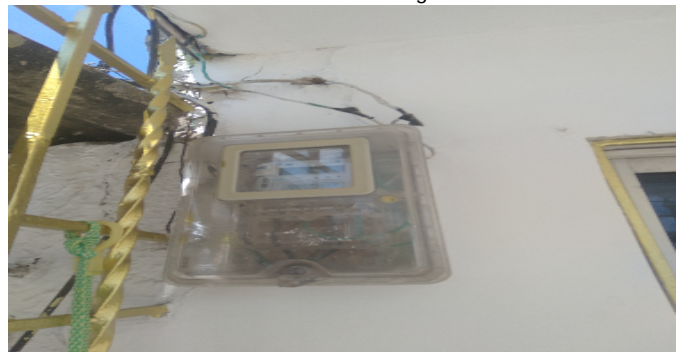
Contador de Energia
