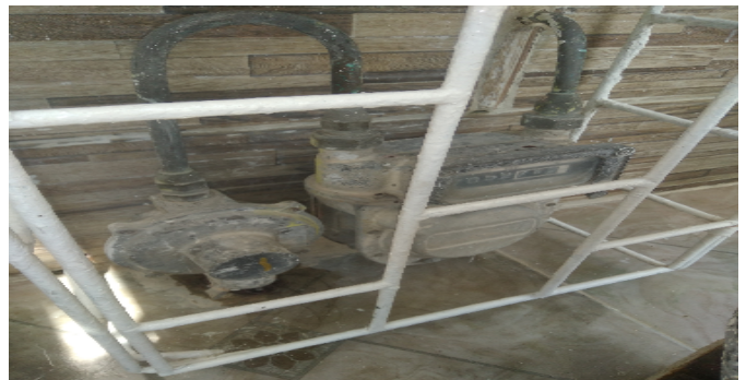
Contador de Gas
