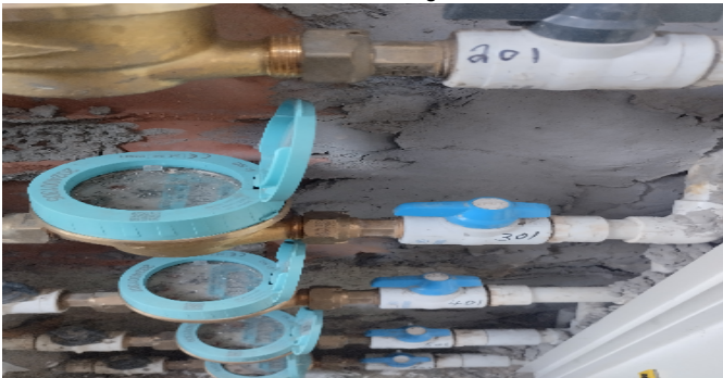
Contador de Agua
