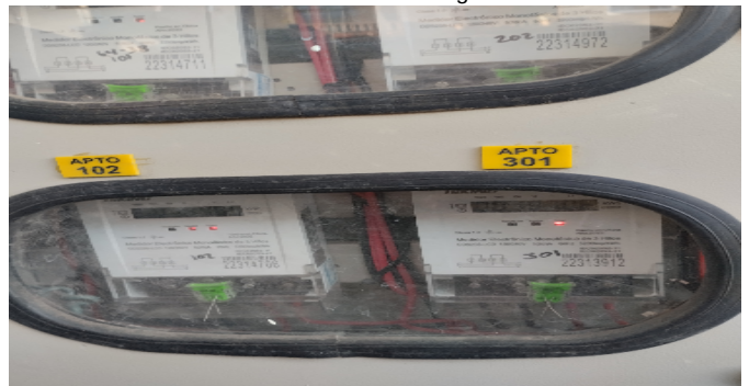
Contador de Energia
