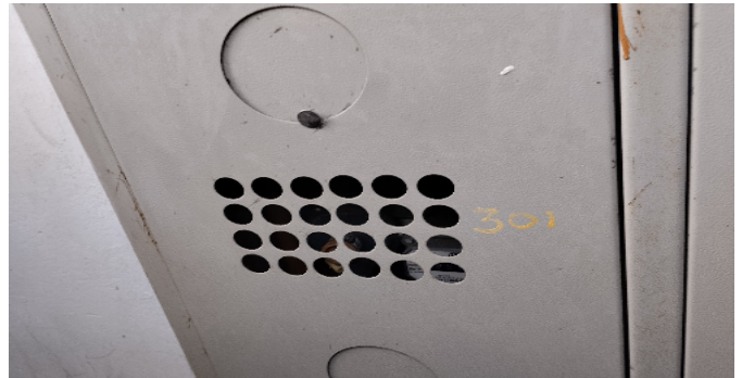
Contador de Gas
