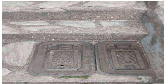
Contador de Agua
