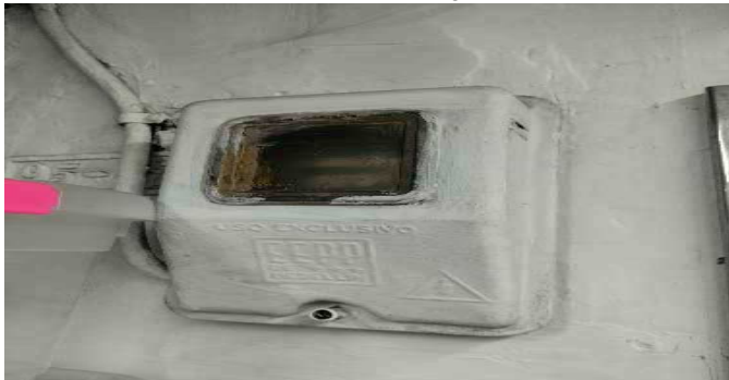
Contador de Energia
