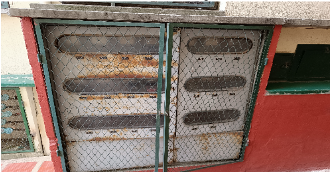
Contador de Energia
