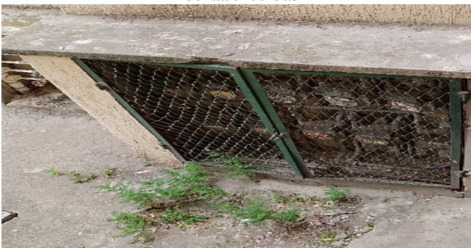
Contador de Gas
