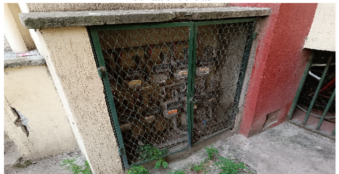
Contador de Gas
