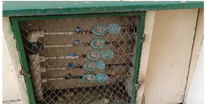
Contador de Agua
