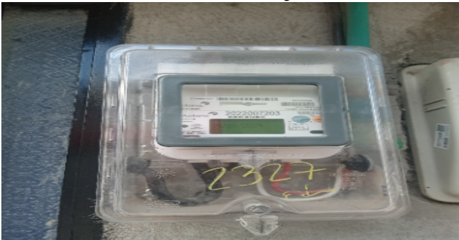
Contador de Energia
