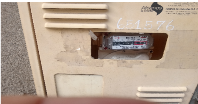
Contador de Gas
