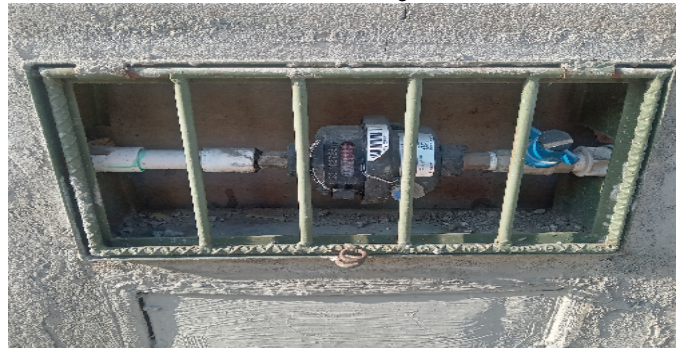
Contador de Agua
