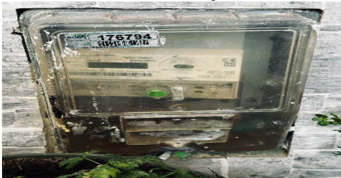
Contador de Energia
