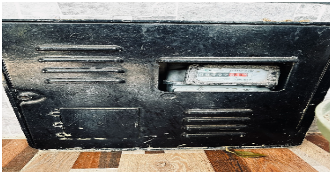
Contador de Gas
