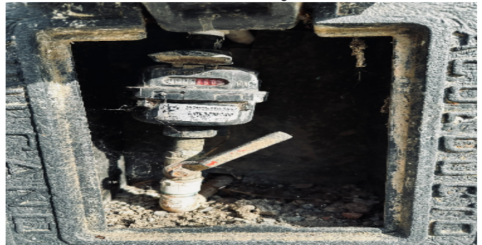
Contador de Agua
