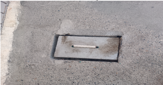
Contador de Agua
