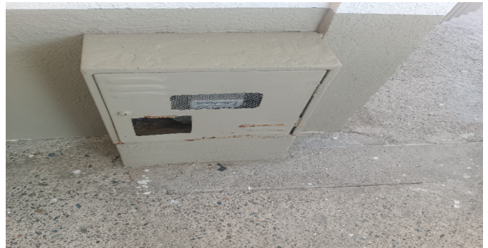
Contador de Gas
