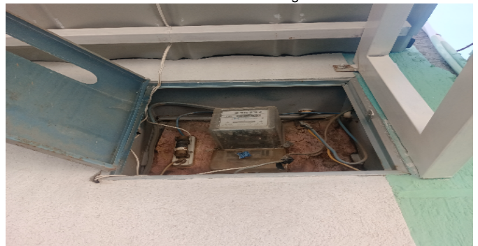
Contador de Energia
