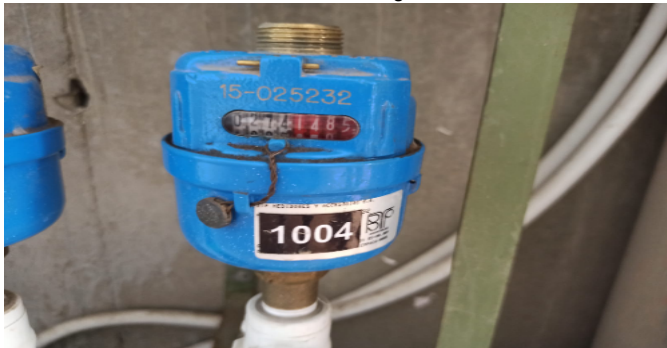
Contador de Agua
