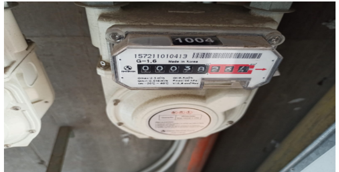
Contador de Gas
