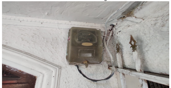
Contador de Energia
