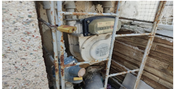
Contador de Gas
