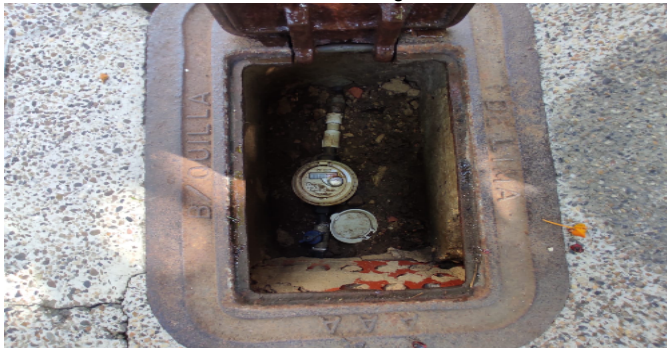
Contador de Agua
