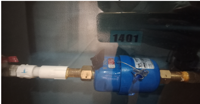
Contador de Agua
