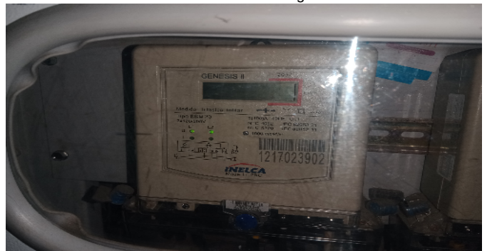
Contador de Energia
