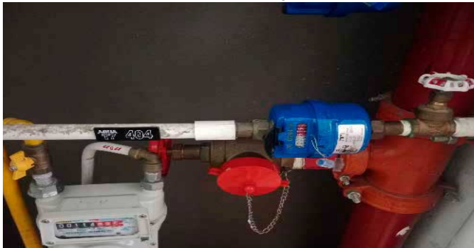
Contador de Agua
