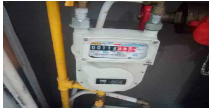
Contador de Gas
