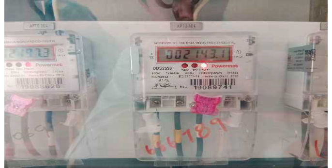
Contador de Energia
