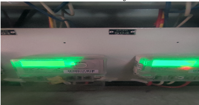
Contador de Energia
