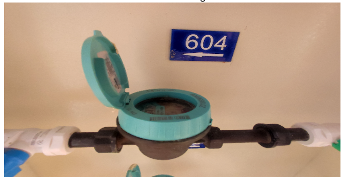
Contador de Agua
