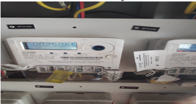
Contador de Energia
