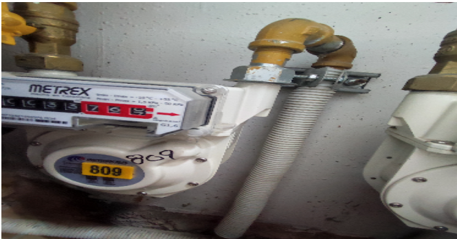
Contador de Gas
