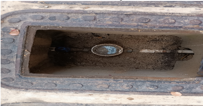
Contador de Agua
