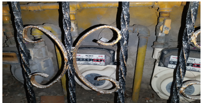
Contador de Gas
