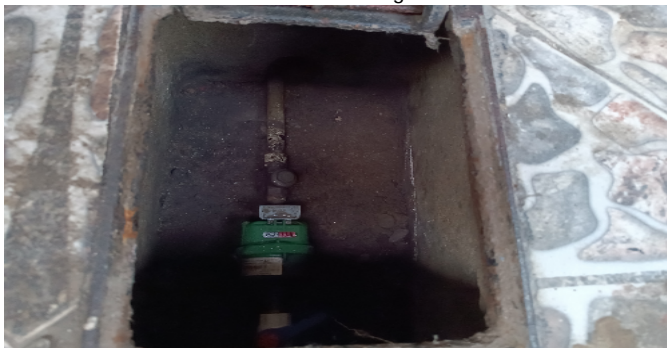
Contador de Agua
