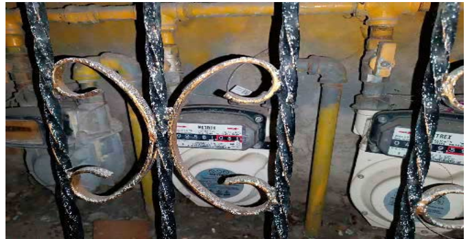
Contador de Gas
