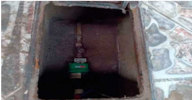
Contador de Agua
