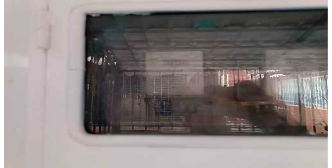
Contador de Energia
