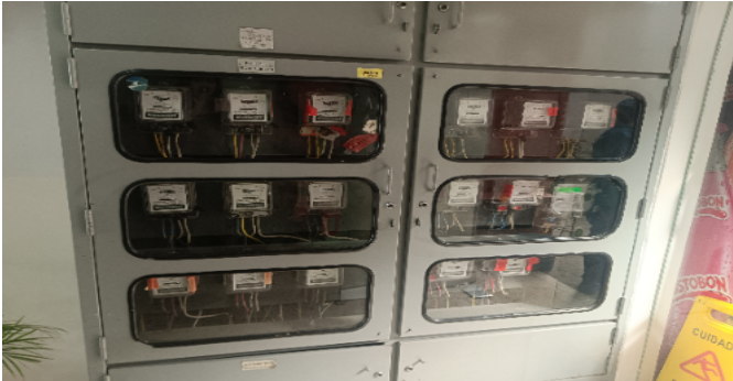
Contador de Energia
