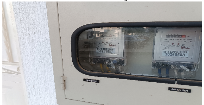
Contador de Energia
