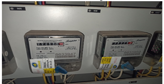
Contador de Energia
