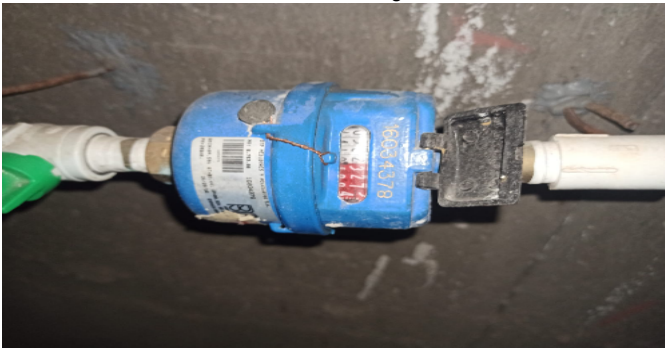
Contador de Agua
