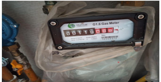
Contador de Gas
