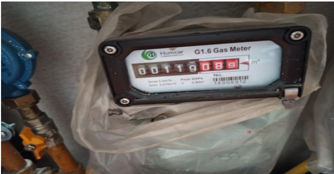
Contador de Gas
