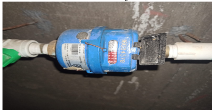
Contador de Agua
