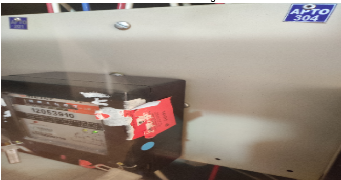
Contador de Energia
