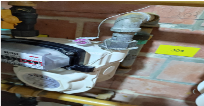
Contador de Gas
