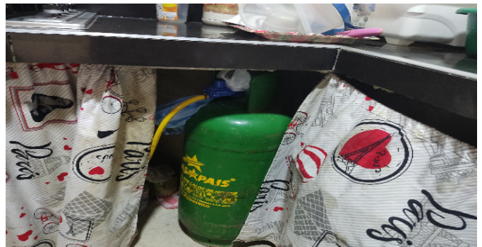
Contador de Gas
