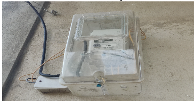
Contador de Energia
