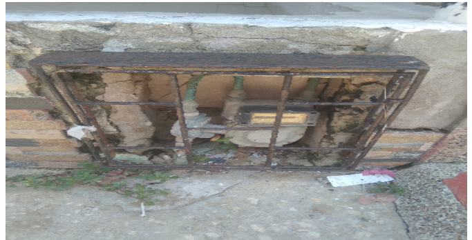
Contador de Gas
