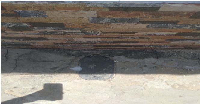
Contador de Agua
