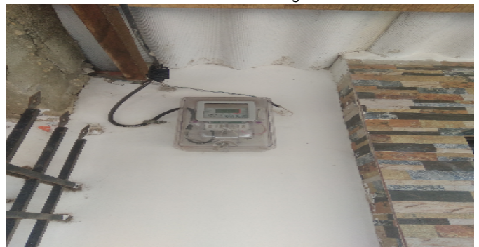
Contador de Energia
