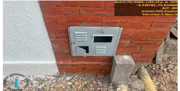
acometida de gas por instalar
