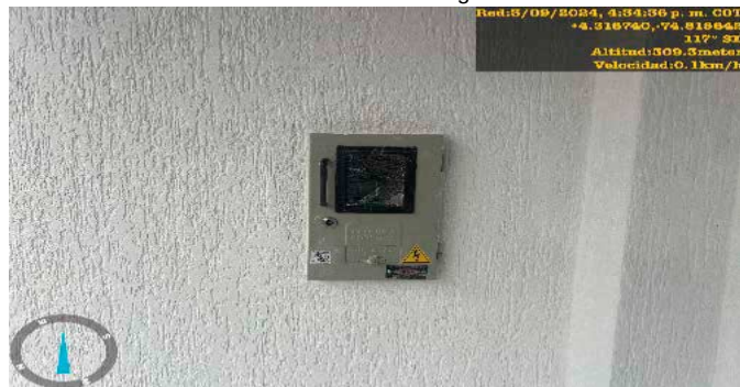
Contador de Energia
