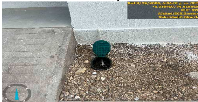
Contador de Agua
