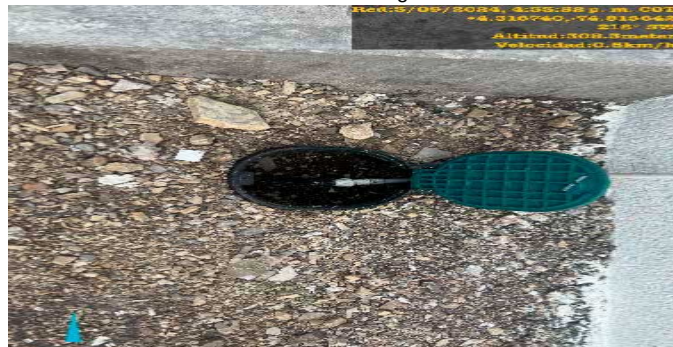
Contador de Agua
