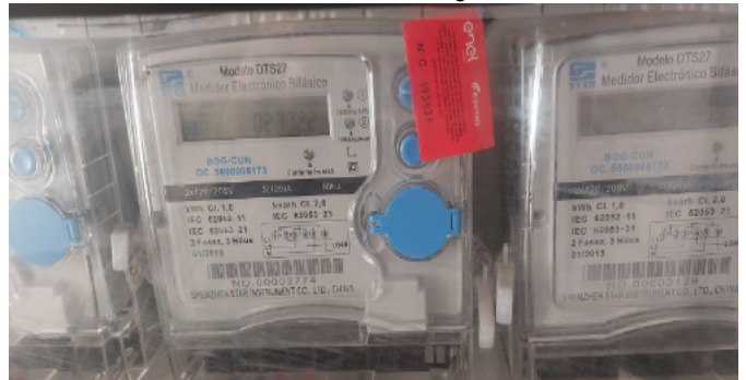
Contador de Energia
