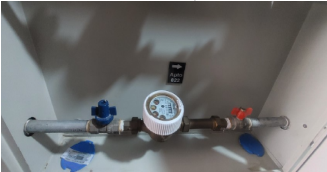
Contador de Agua
