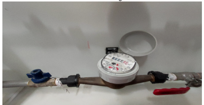
Contador de Agua
