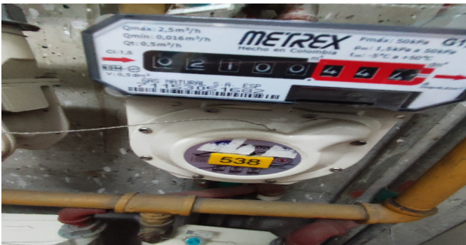
Contador de Gas
