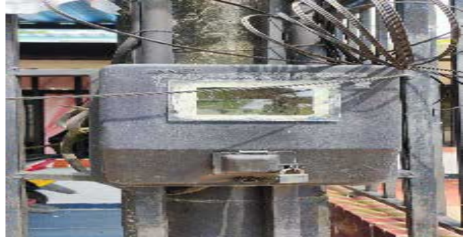
Contador de Energia
