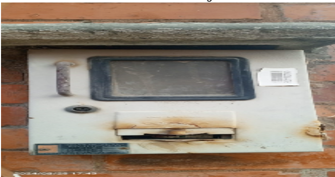
Contador de Energia
