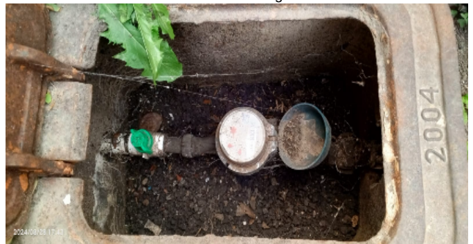
Contador de Agua
