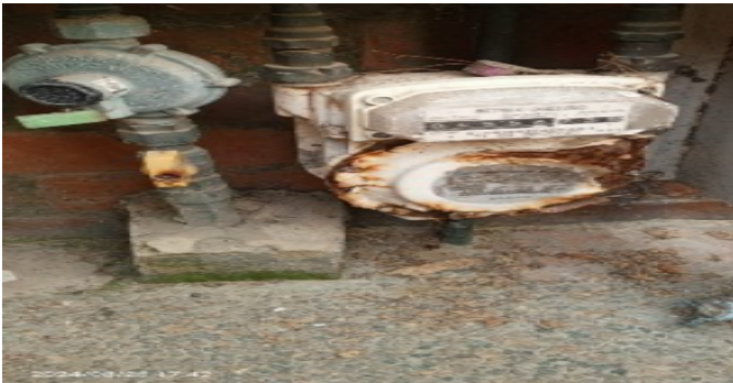
Contador de Gas
