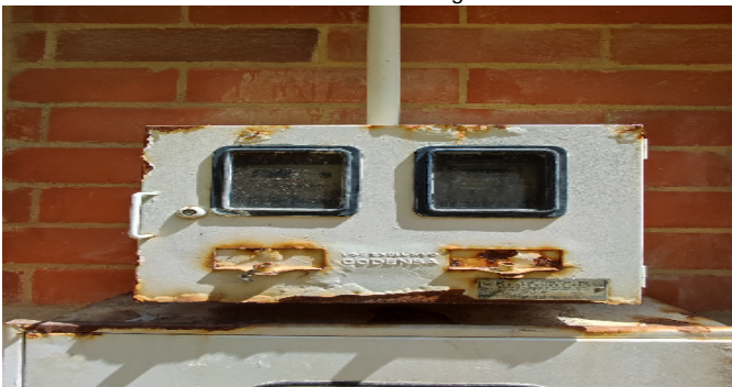
Contador de Energia
