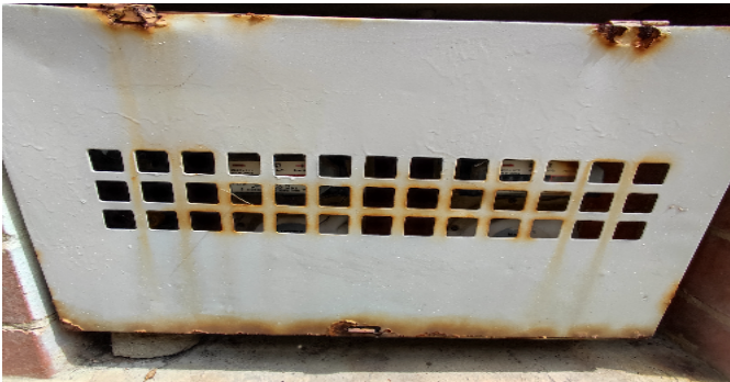
Contador de Gas
