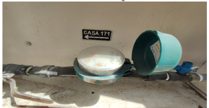
Contador de Agua
