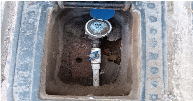
Contador de Agua
