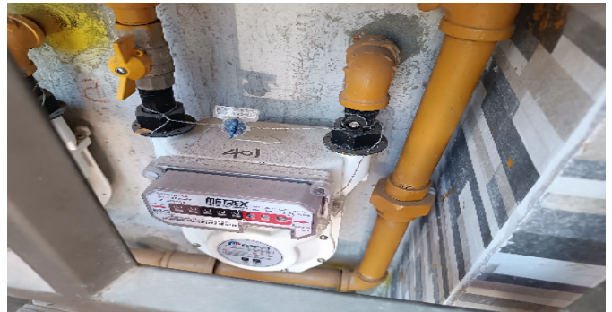
Contador de Gas
