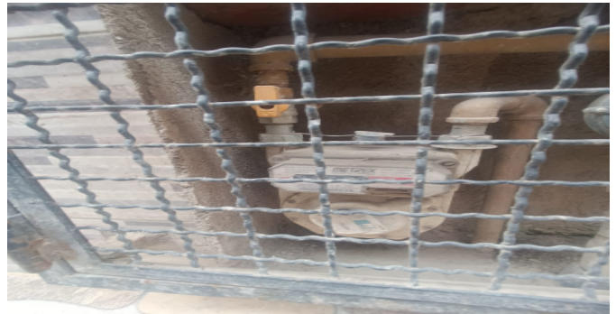
Contador de Gas
