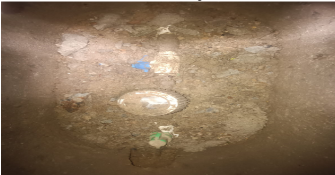
Contador de Agua
