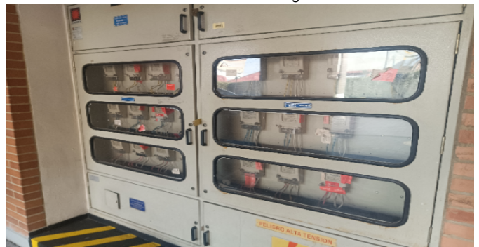
Contador de Energia
