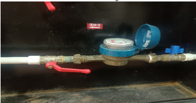
Contador de Agua
