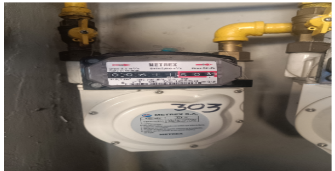
Contador de Gas
