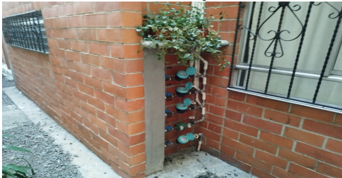
Contador de Agua
