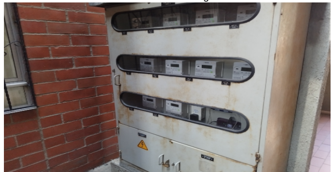
Contador de Energia
