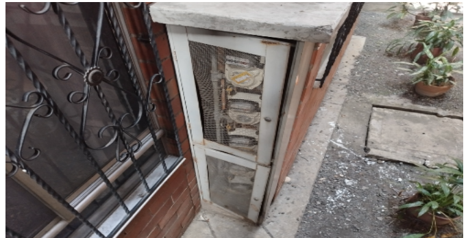
Contador de Gas
