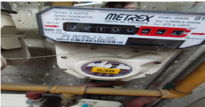
Contador de Gas
