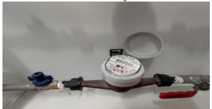
Contador de Agua
