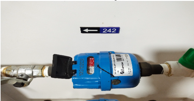
Contador de Agua
