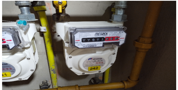
Contador de Gas
