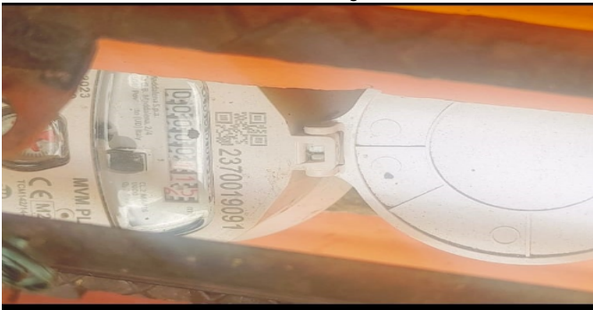
Contador de Agua
