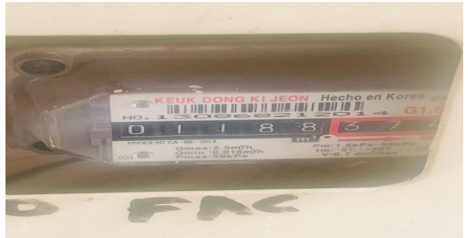
Contador de Gas
