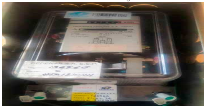
Contador de Energia
