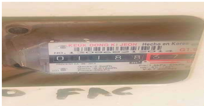
Contador de Gas
