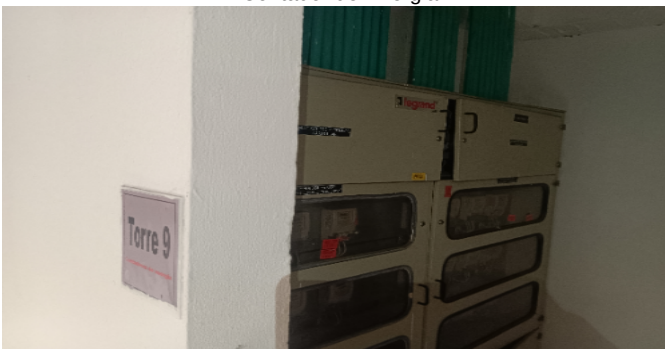
Contador de Energia
