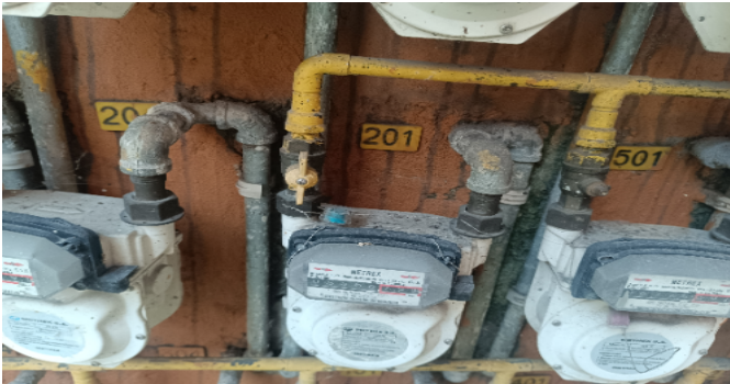
Contador de Gas
