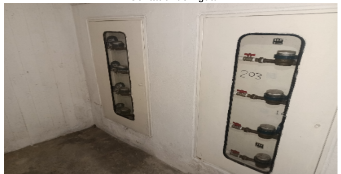
Contador de Agua
