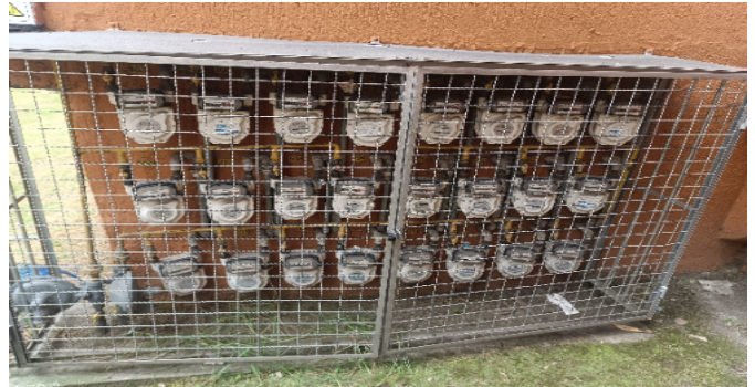
Contador de Gas
