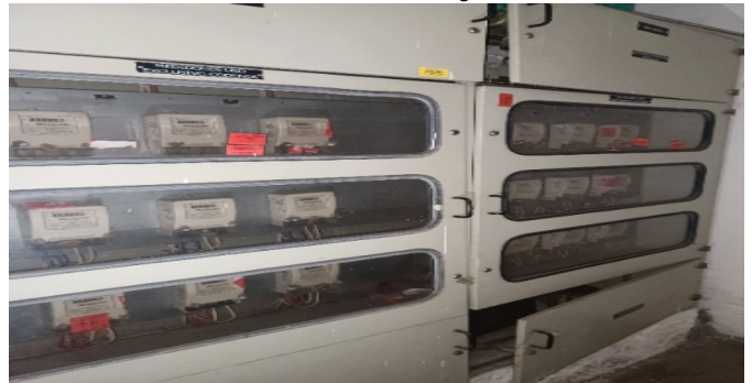
Contador de Energia
