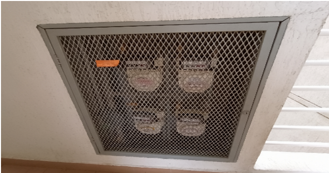
Contador de Gas
