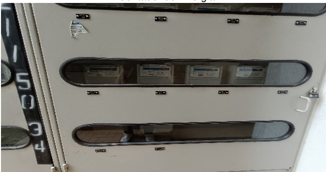
Contador de Energia
